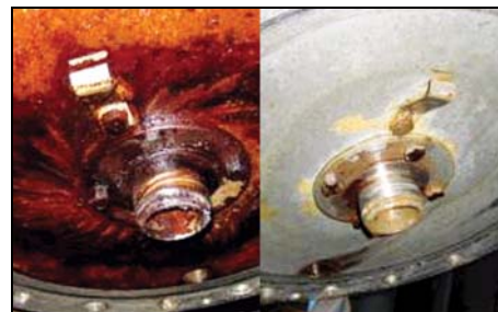
Крышка баллона загрязненный
